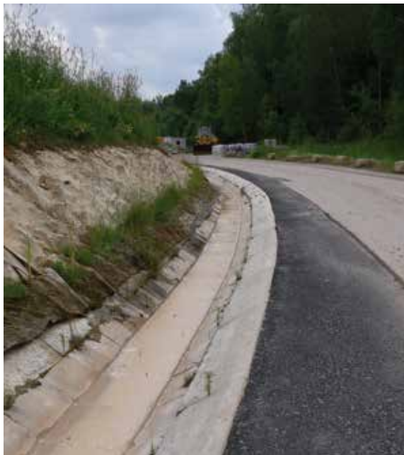
Oberflächenwasserableitung in Sohlschalen Surface water drainage in channel slabs
